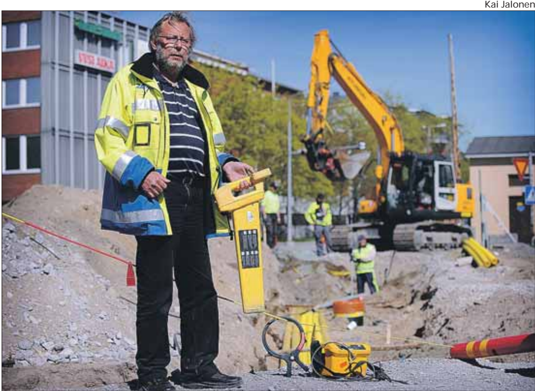
Rauman Energian Jarmo Jussilalle kaapeleita paljastava näyttötutka on tuttu ja usein käytössä oleva työväline.
